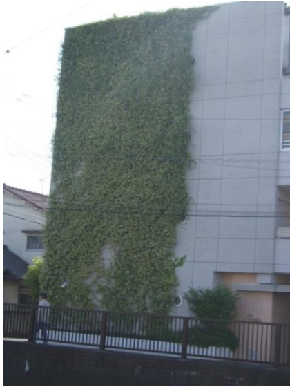
建物の外壁に成長したテイカカズラ
